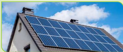
Мал. 120. Сонячні батареї на даху приватного будинку
